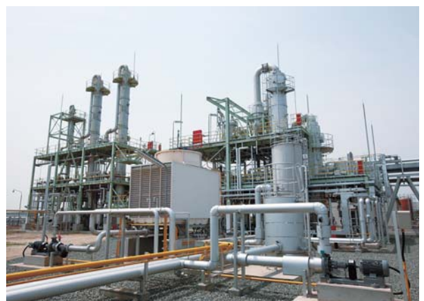
2008年3月稼働 特殊モノマー設備
